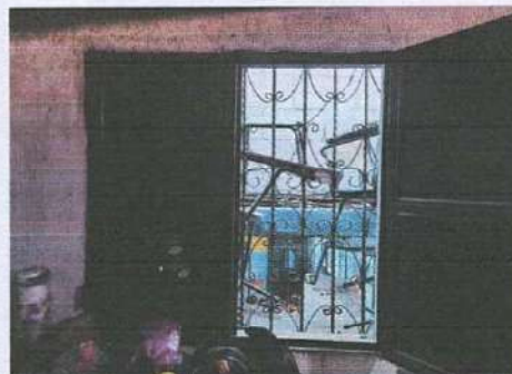
FOTO 2: Cambiar ventanas en mal estado y abrir otras ventanas para mas ventilación en cocina
