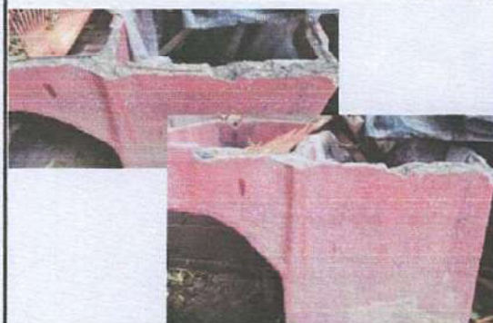
FOTO 10: Pila ya no sirve, se filtra el agua y está quebrada.
