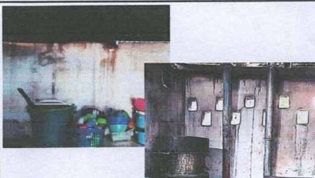
FOTO 4: Pintura en cocina y en aulas en deterioro.
