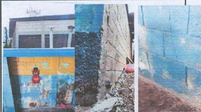
FOTO 3: Hace falta cernido en paredes de cocina y de aula, alisado en paredes que ya tiene presencia de hongo (salitre) por humedad, mas reparar y resanar pared de cocina
