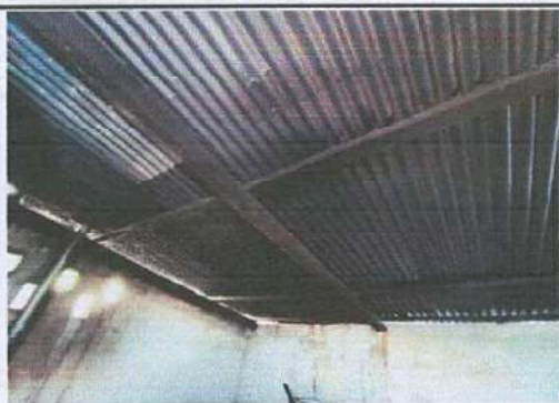
FOTO 1: Cambiar Estructura de madera y lámina que ya están viejas y cumplieron su vida útil en cocina.
