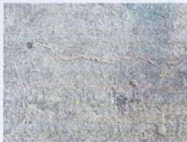
FOTO 7: Losa de patio rajado y se está levantando.
